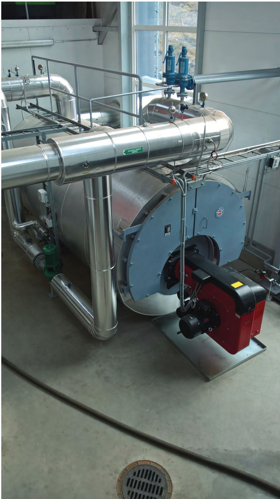
Lehtiniemen biolämpökeskuksen varaöljykattila, 4MW.
