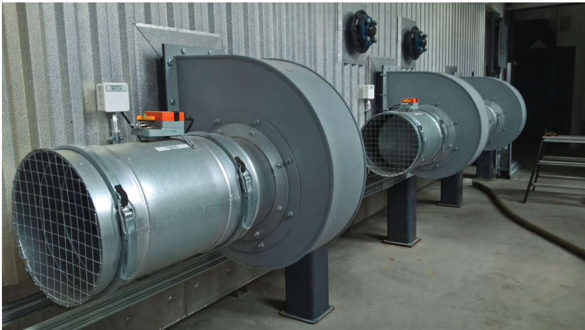
Fläktarna som blåser in förbränningsluft i tre zoner till den mindre 4 MW biopannan i Lövnäs.
