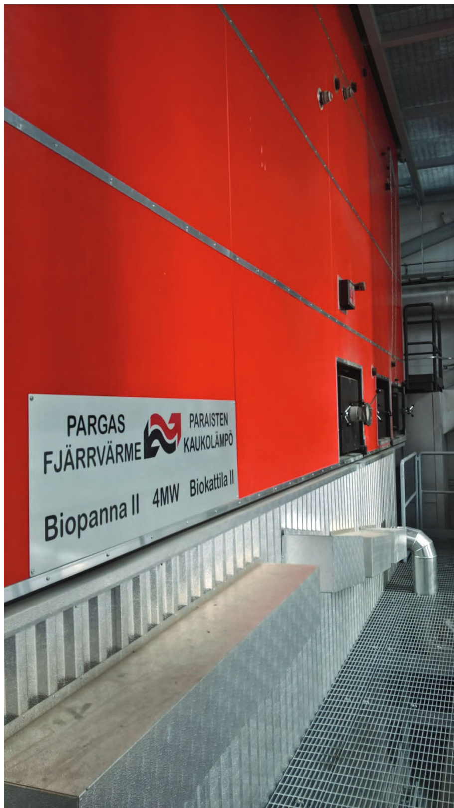
Lehtiniemen biolämpökeskuksen pienempi 4 MW kattila.
