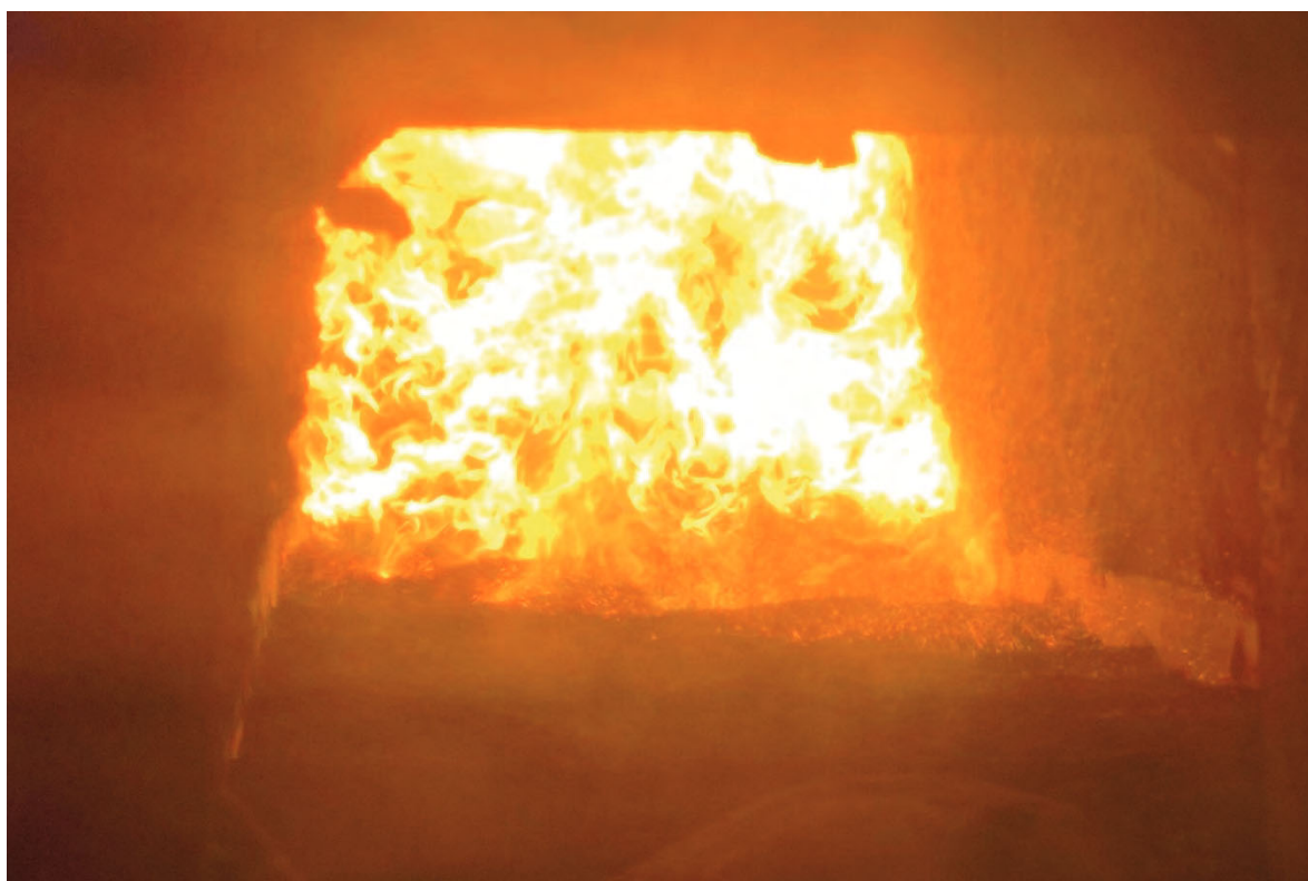
Förbränningszonen i 4 MW biopannan i Lövnäs.
