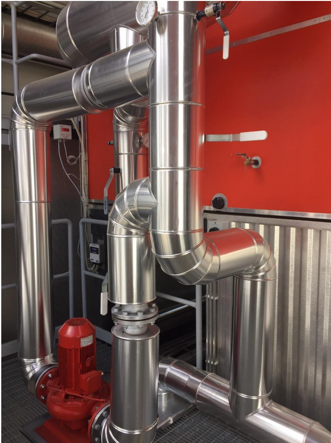
Kattilan arinan kierto-vesiputkisto on tärkeä osa kattilan eliniän kannalta
