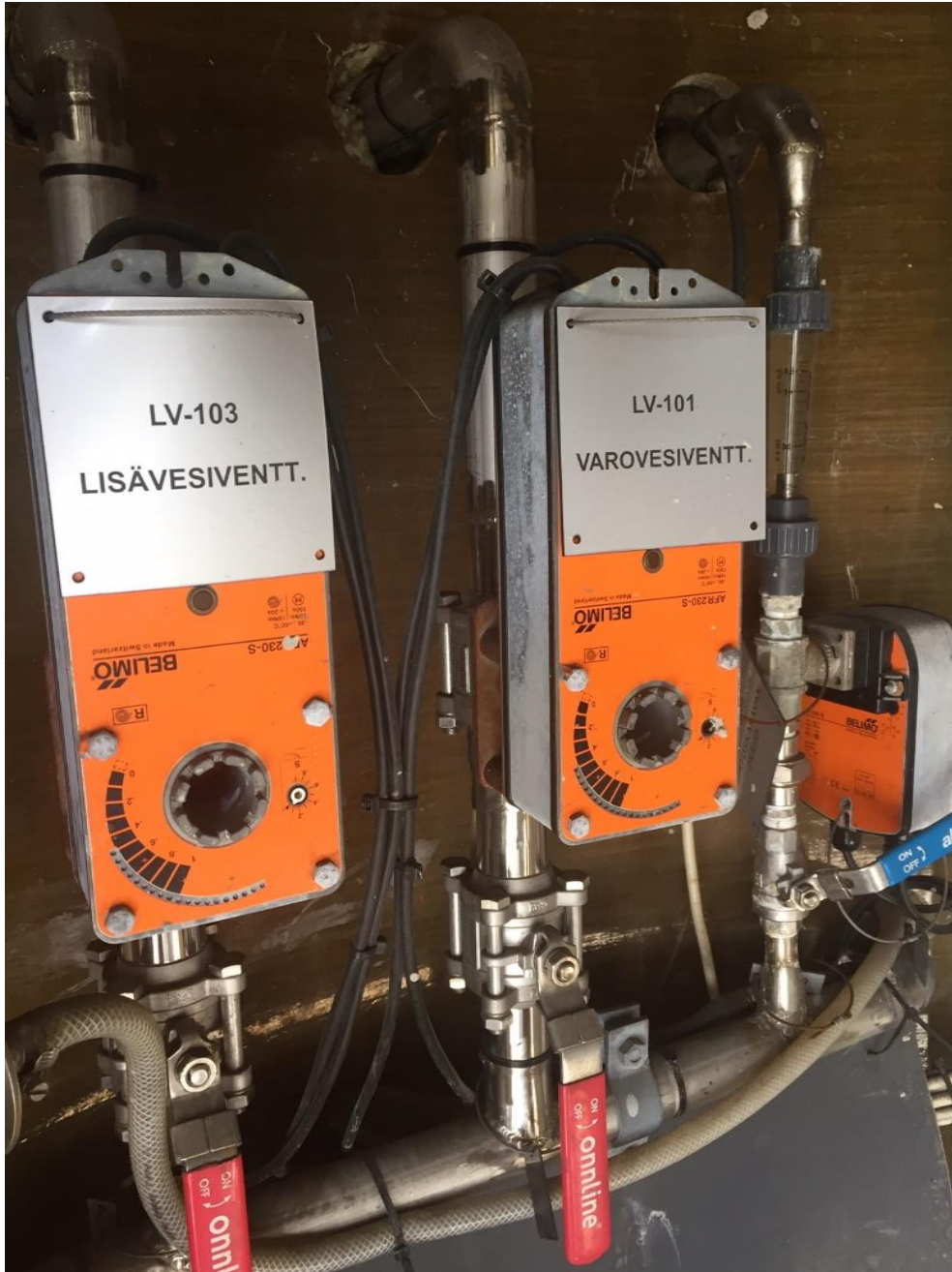
Bio 1 kattilan savupiipussa on tehokas lämmöntalteenotto säätöineen.
